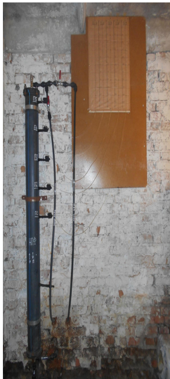
Рис. 8. Лабораторная установка обезжелезивания подземных вод биологическим методом (блок Б-КПФ с пенополистирольной загрузкой и пьезометрическим щитом)
